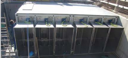
ECCODUST Wienerwald, exhaust air
